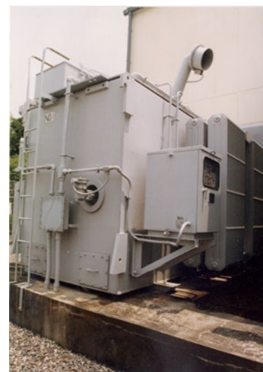
廃棄された特別高圧トランス
