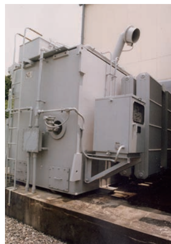
廃棄された特別高圧トランス
