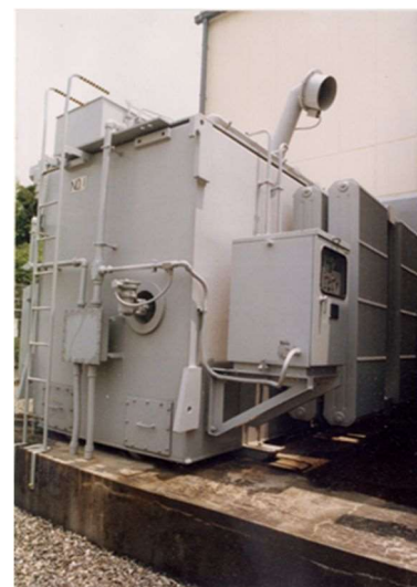
廃棄された特別高圧トランス
